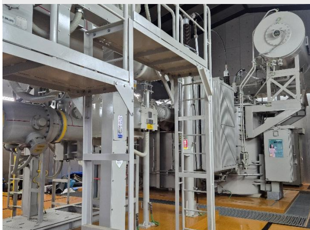
그림4 변전소에 붙어 설치될 장주기 ESS
