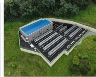
[약목에코파크 (9MW)] ( '24년 9월 상업운전) REC 구매 : GS파워
