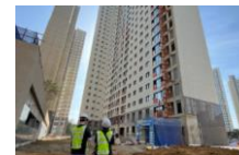
건설 현장 균열 감지 데이터 구축 [P건설]
