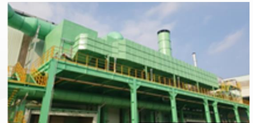
※ 대기오염방지시설을 설치한 3L 도장공장
